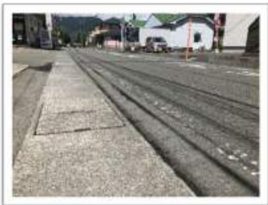
始良小正門前の通学路(改良前)
